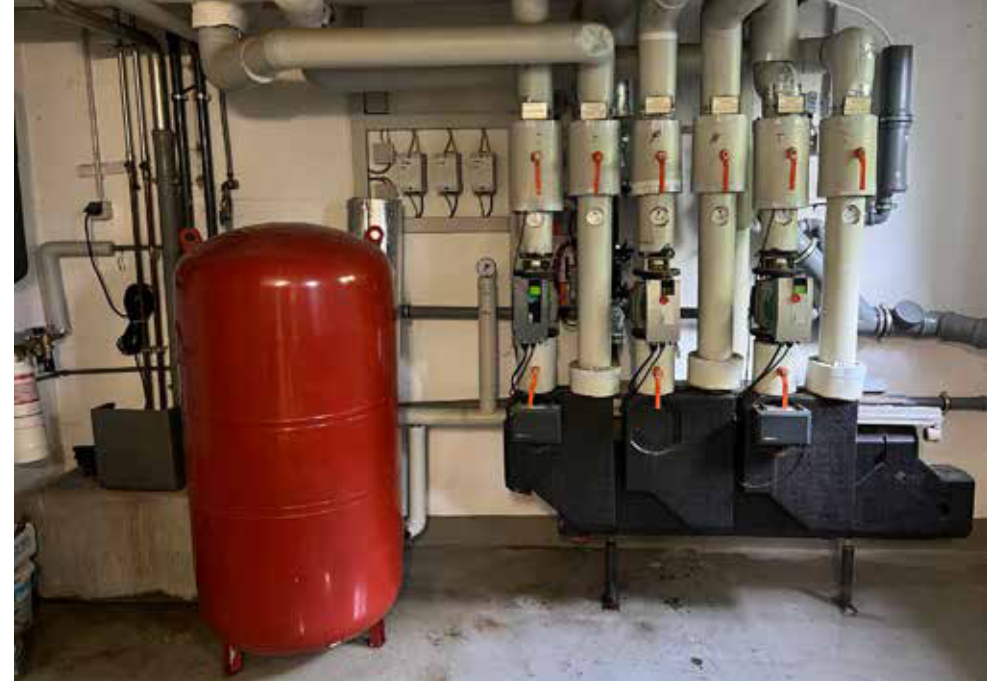
Heizungskeller im Pestalozziweg 2 und 4 in Rheda-Wiedenbrück
